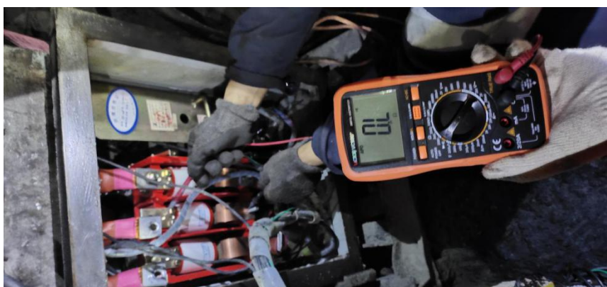
图 8 巷修机分馈开关 C 相真空管测量
