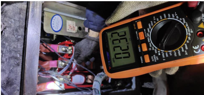
图 6 巷修机分馈开关 A 相真空管测量
