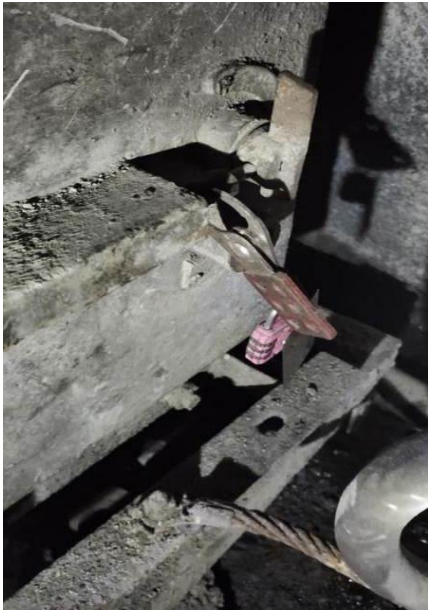
图 4 巷修供电分馈开关闭锁装置
