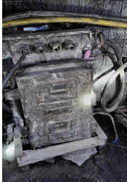
图 5 巷修机供电分馈开关
