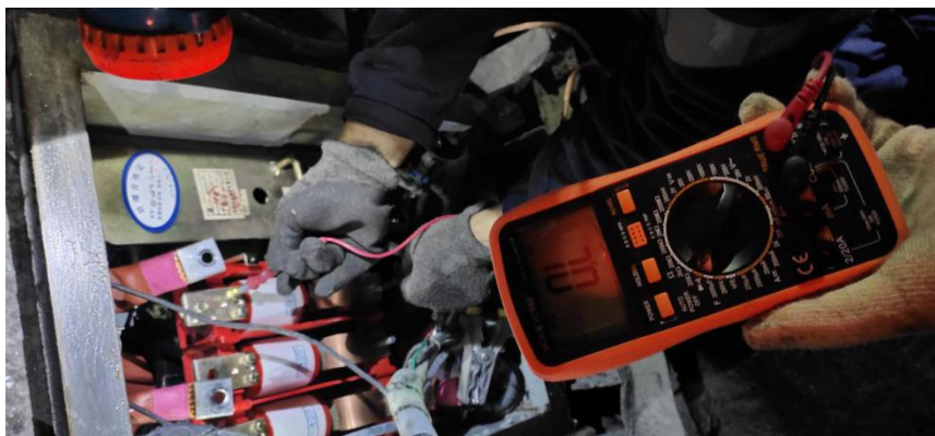
图 7 巷修机分馈开关 B 相真空管测量
